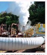
地熱発電所蒸気生産基地
